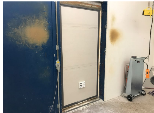
Bild 14 – Uteluftsdon YSO 16012012 monterat i provväggen.
